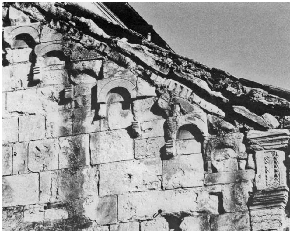
Un'eloquente immagine del degrado della cornice di coronamento dell'a la destra della facciata.
