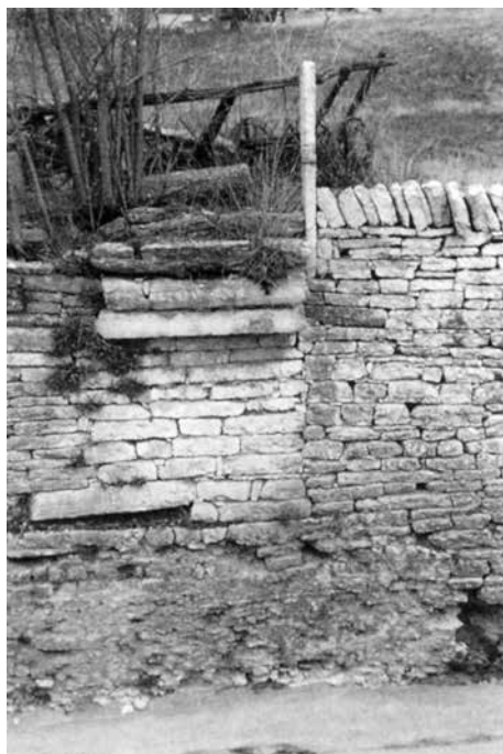
Resti del muro di sostegno del terrapieno posto a monte della strada con tracce del demolito ponte in lastre di pietra su longarine di ferro.
