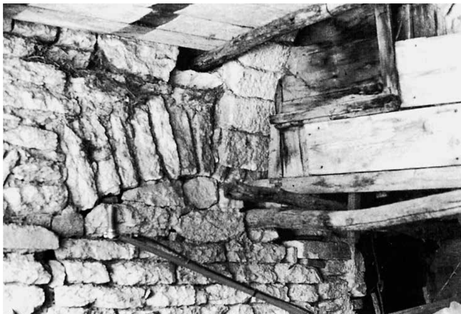
Particolare della muratura della torre nel sottoportico. È evidente la finestra (?) tamponata sovrastata dalla ghiera dell'arco del porticato..
