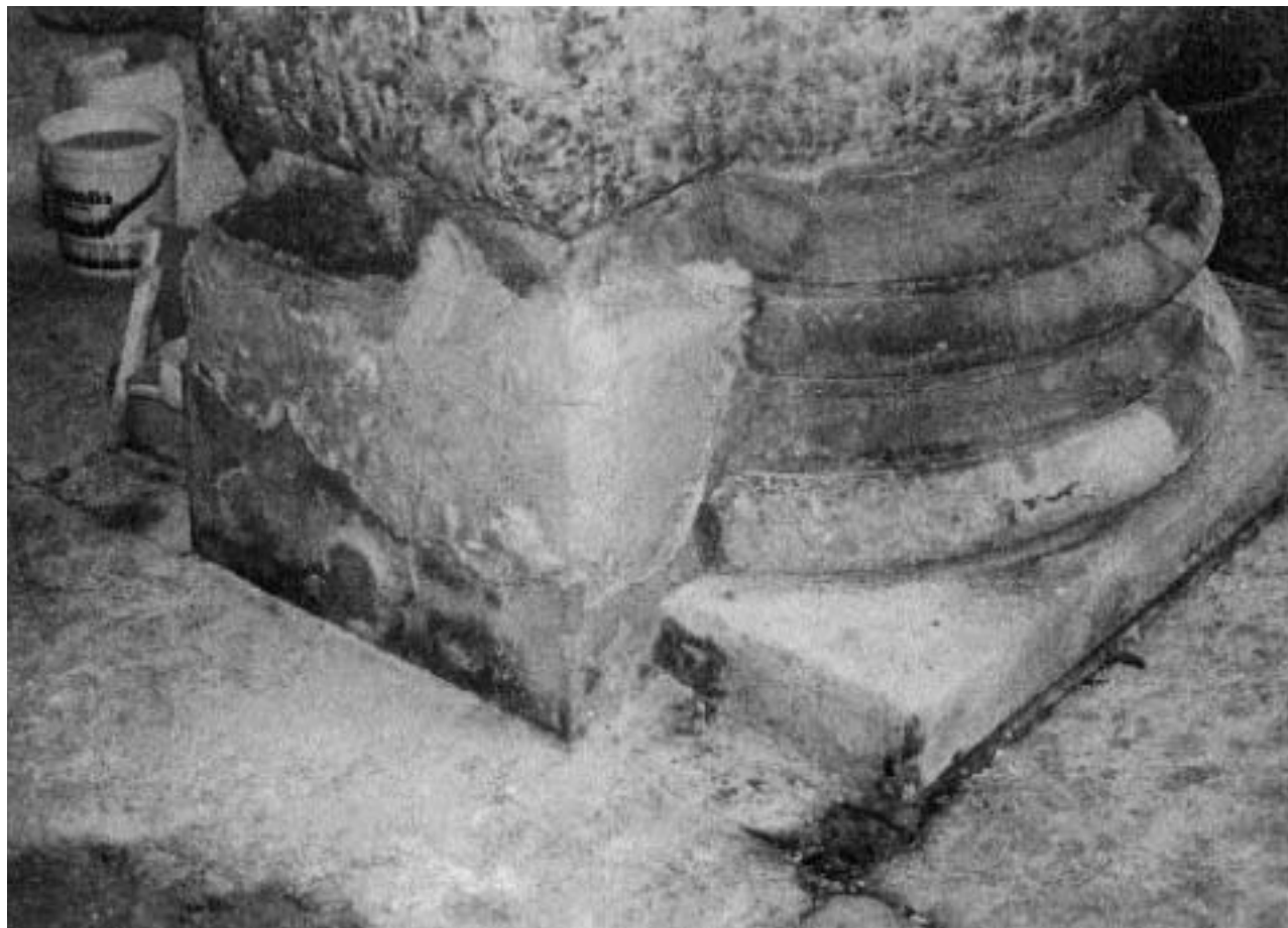
Fig. 9. Basi delle colonne prima dell'intervento del 1992; è evidente l'utilizzo di cemento sotto l'intonaco.
