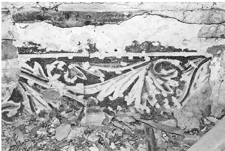
Il fregio a girali rossi e ocra rinvenuto sulle murature del sottotetto.
